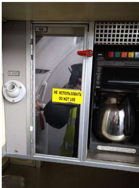
Рис. 2. «Неисправный» отсек кухни
