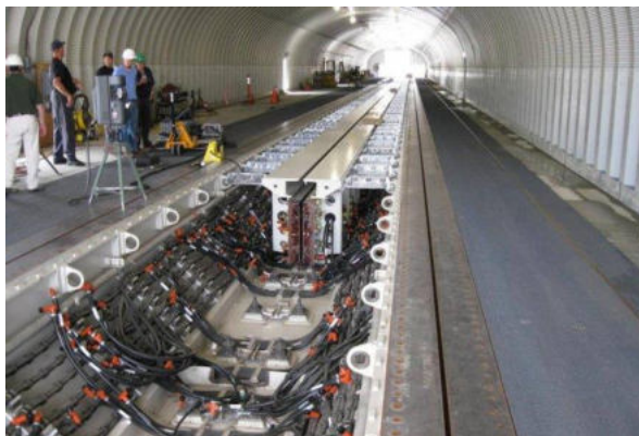
Рисунок 5. Линейный индукционный двигатель электромагнитной катапульты (EMALS) в процессе монтажа и наладки. Для исключения влияния атмосферных осадков работы ведутся под навесом, длина которого впечатляет всякого человека, способного не предвзято оценить грандиозность сооружения и стоимость выполняемых работ.
